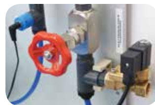
Valvola a spillo inox 316 ed elettrovalvola di flussaggio.
