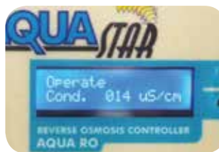
Programmatore elettronico con conduttivimetro per il controllo della qualità del permeato.
